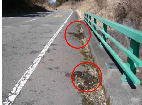
排水樹の土砂詰り（清掃前）
