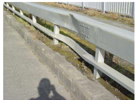
写真 2 防護柵の著しい変形
