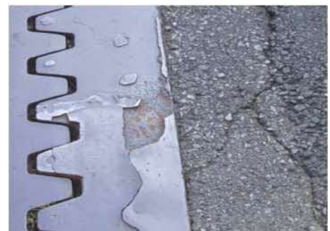
写真 3 伸縮装置の欠損
