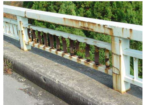
写真 1 高欄部材の欠損
