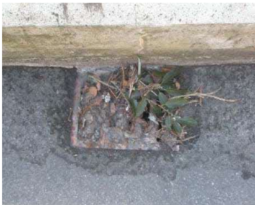
土砂詰り状況
