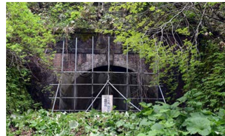
▲大正11年竣工の旧中山トンネル。稜線下15mの高所にあるにもかかわらず、相当量の湧水があったことが記録されています。
