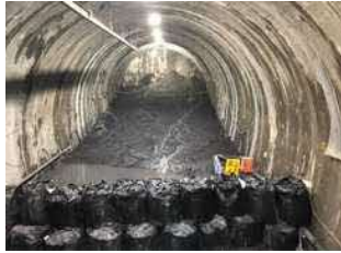
トンネル坑内土砂流入状況
