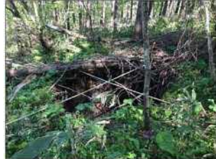
地表面陥没状況
