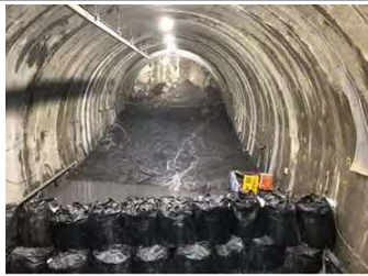
トンネル坑内土砂流入状況
