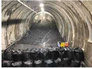
トンネル坑内土砂流入状況
