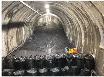
トンネル坑内土砂流入状況
