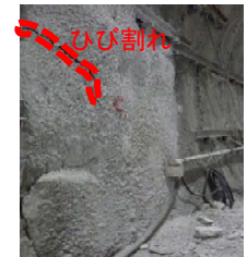
吹付けコンクリートのひび割れ
