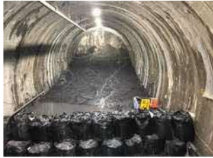
トンネル坑内土砂流入状況
