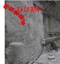
吹付けコンクリートのひび割れ
