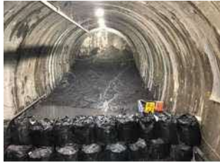
トンネル坑内土砂流入状況
