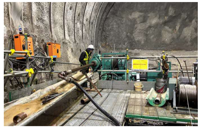
天狗工区から新函館北斗方への長尺ボーリング実施状況
