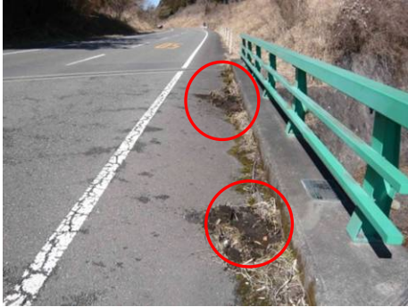
排水樹の土砂詰り（清掃前）
