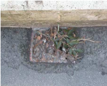
土砂詰り状況
