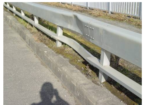
写真2 防護柵の著しい変形
