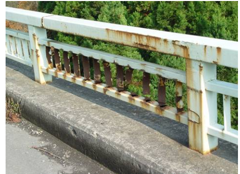
写真1 高欄部材の欠損
