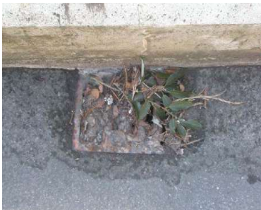
土砂詰り状況
