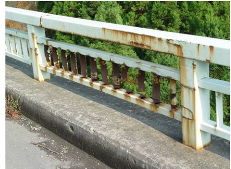
写真 1 高欄部材の欠損
