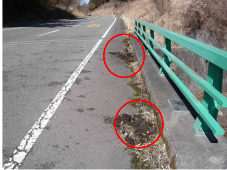
排水樹の土砂詰り（清掃前）
