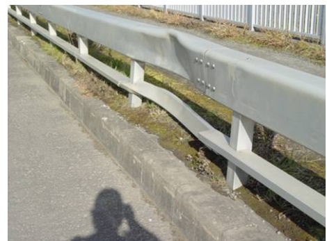
写真 2 防護柵の著しい変形
